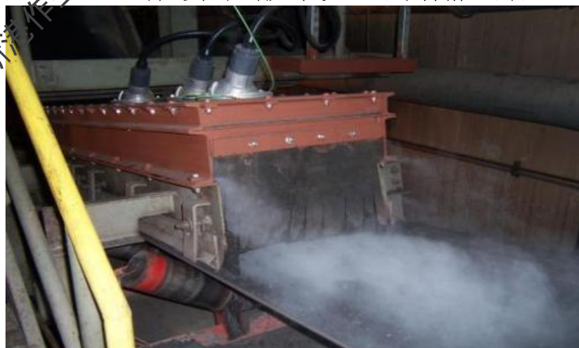
图 6.2-4 转运站下游皮带机密闭导料槽示例图
