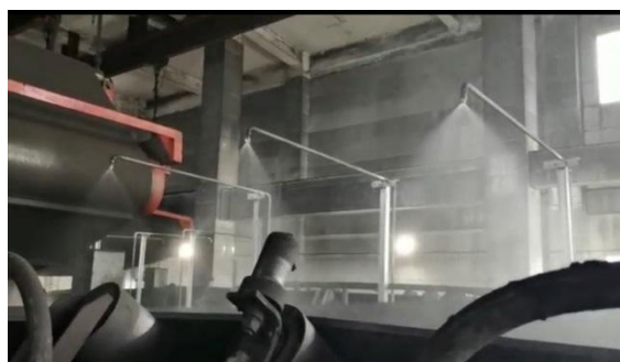
转运站水喷淋设施
